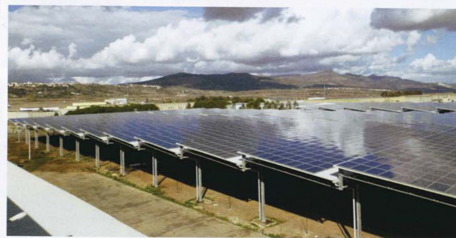
IMPIANTO FOTOVOLTAICO INDUSTRIALE
