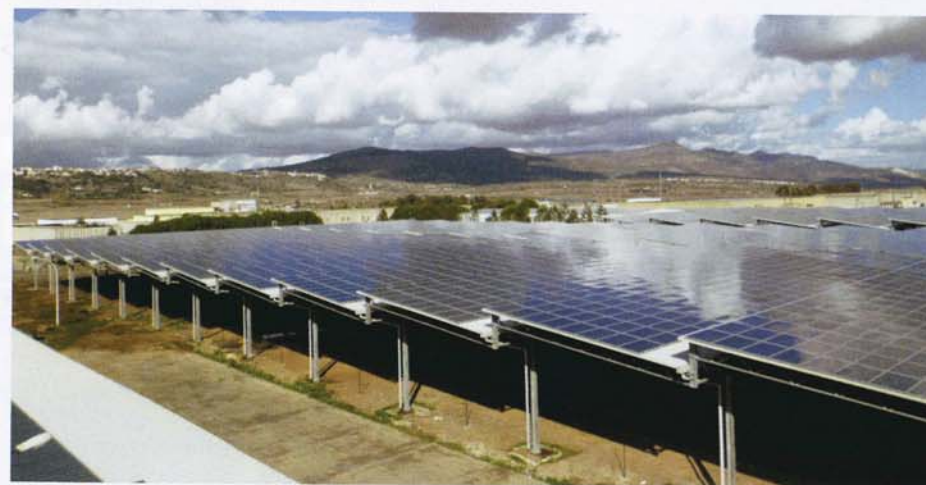
IMPIANTO FOTOVOLTAICO INDUSTRIALE
