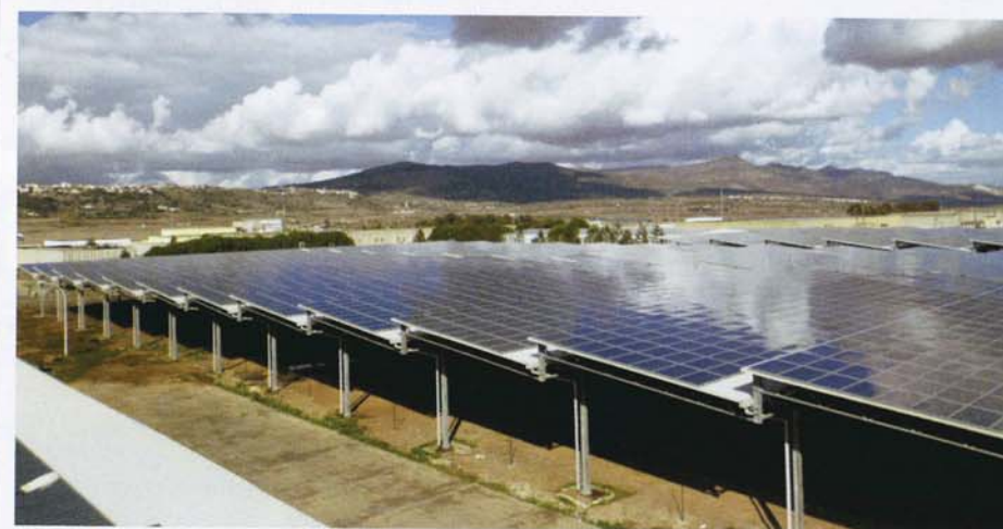
IMPIANTO FOTOVOLTAICO INDUSTRIALE
