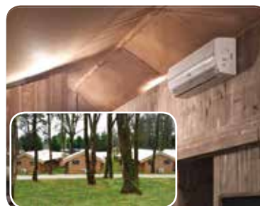
Impianto di Climatizzazione presso Glamping in Francia
