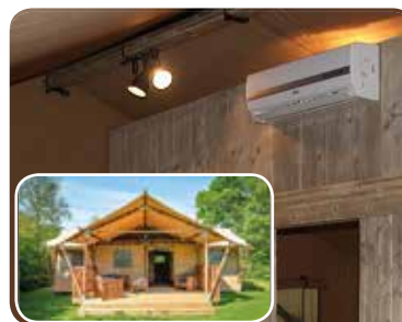
Impianto di Climatizzazione presso Glamping in Croazia
