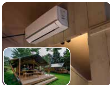
Impianto di Climatizzazione presso Glamping in Austria
