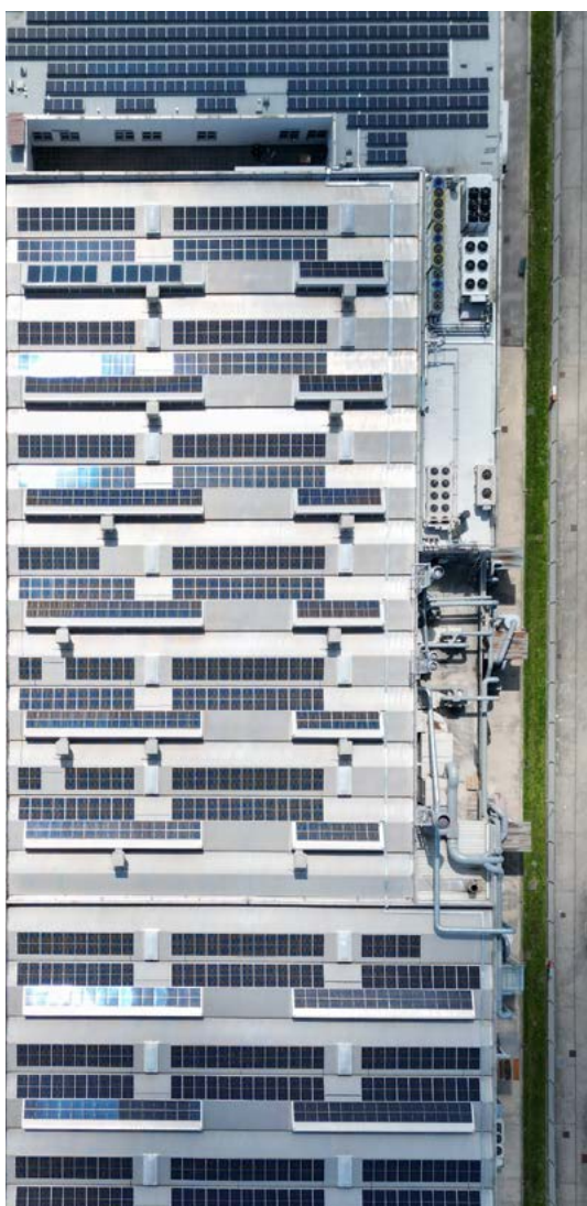
Impianto di 432,27 kWp a Coadoneghe (Padova), produzione annua stimata 490.940 kWh/anno
